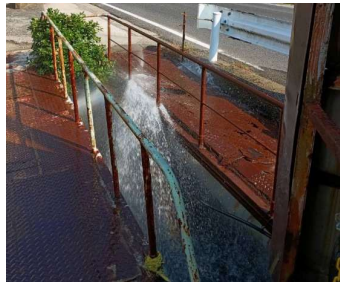
水管橋漏水(美保関町)
