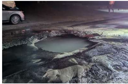
漏水による道路陥没(黒田町)
