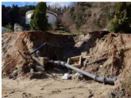
浄水場内の配管損傷（七尾市）
