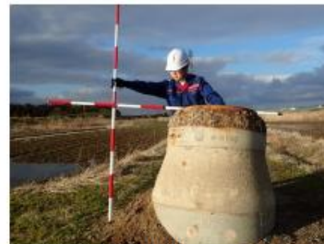
マンホール浮上現場（中能登町）
