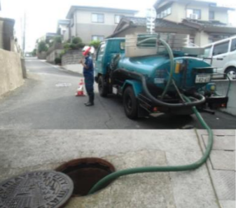
図14. バキューム車での汲み取り
