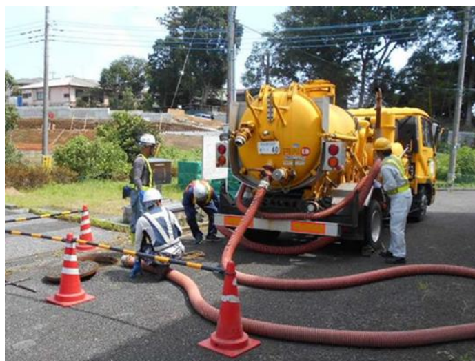
図 5-8 バキューム車での汲み取り
