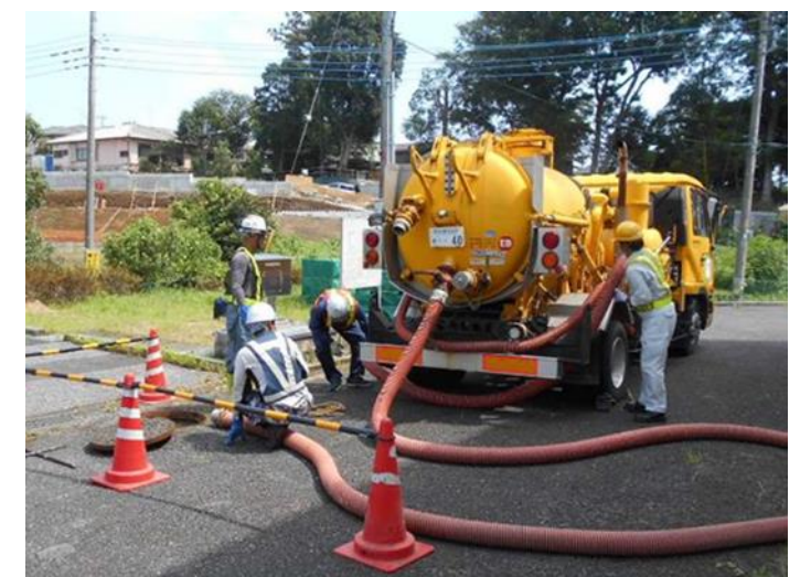
図 19. バキューム車での汲み取り
