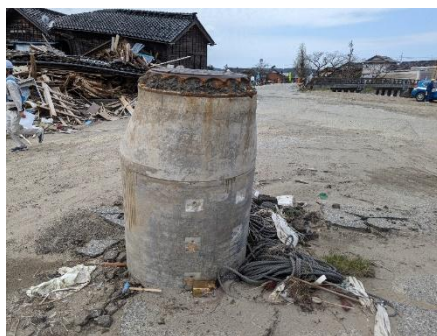
図：液状化によるマンホールの浮上 (2024年1月 能登半島地震)
