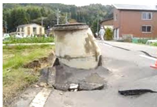
図：液状化によるマンホールの浮上 (2004年 新潟県中越地震)
