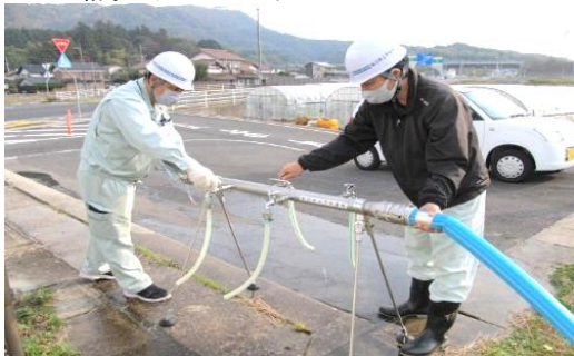
皆美が丘女子高グラウンド給水ステーション
