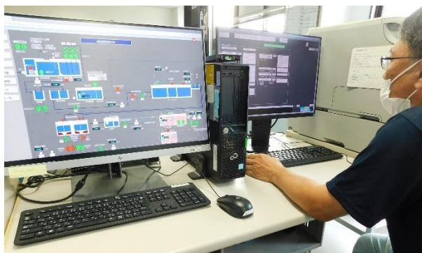
水道・下水道施設の遠隔監視システム
