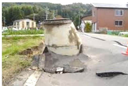
液状化によるマンホールの浮上(2004年 新潟県中越地震)
