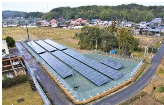
竹矢ポンプ場敷地を活用した太陽光発電設備
